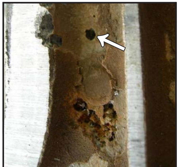
Korrosion am SEplus* (mit Lochfraß)
