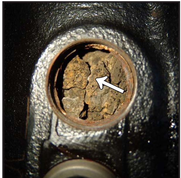
Steinbildung im Motorzylinder/Wärmetauscher
